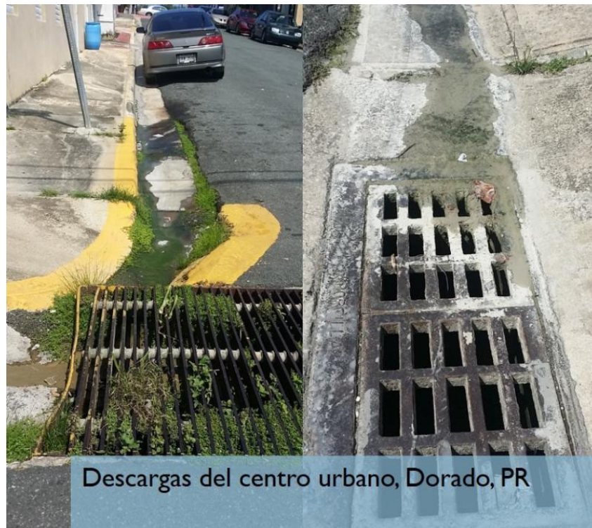
Imagen 59: Conexión a pluvial y descargas
